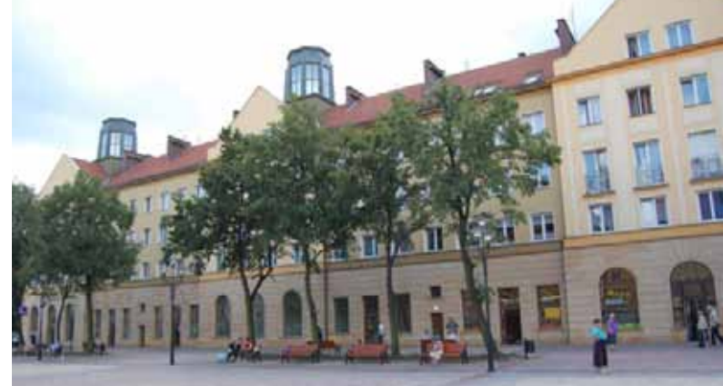
Remont części frontowych kamienic przy placu Baczyńskiego odbył się przy pomocy środków miejskich, ale właściciele dopłacali do tych prac z własnej kieszeni.
