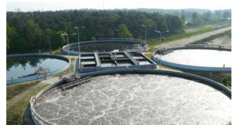
Tyska oczyszczalnia jest jednym z najnowocześniejszych obiektów tego typu w Polsce.
